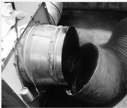
[그림-1] 오염된 다중이용시설의 Duct 내부
